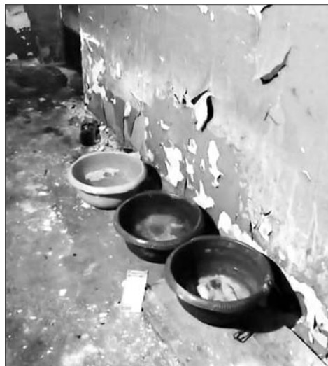
Дождевая вода и тающий снег стекают по плитам в дом.
