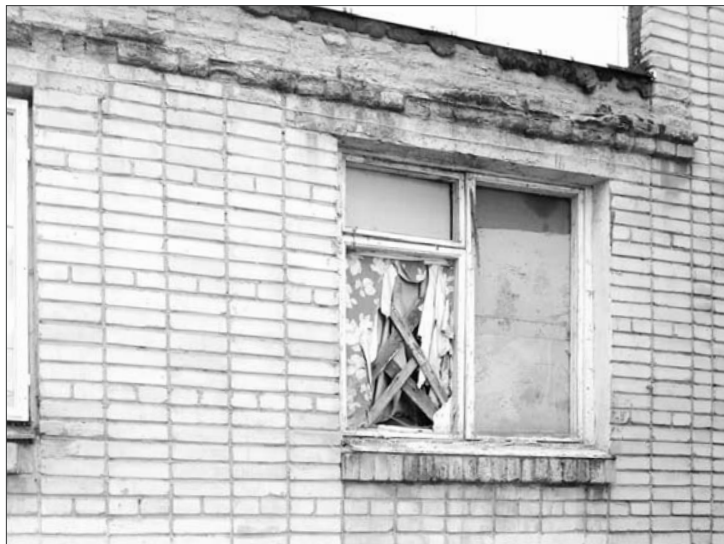
Окна и двери в муниципальных квартирах выбиты.
